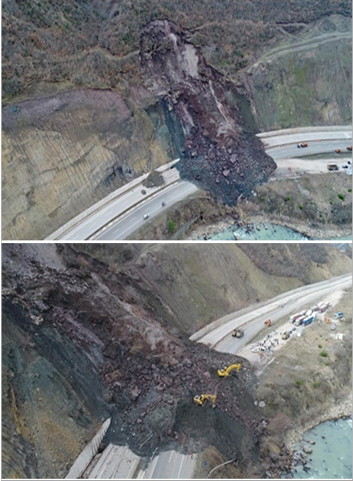
Resim 2.6: Reşadiye-Erzincan Karayolu Yol kenarı Heyelanı*
