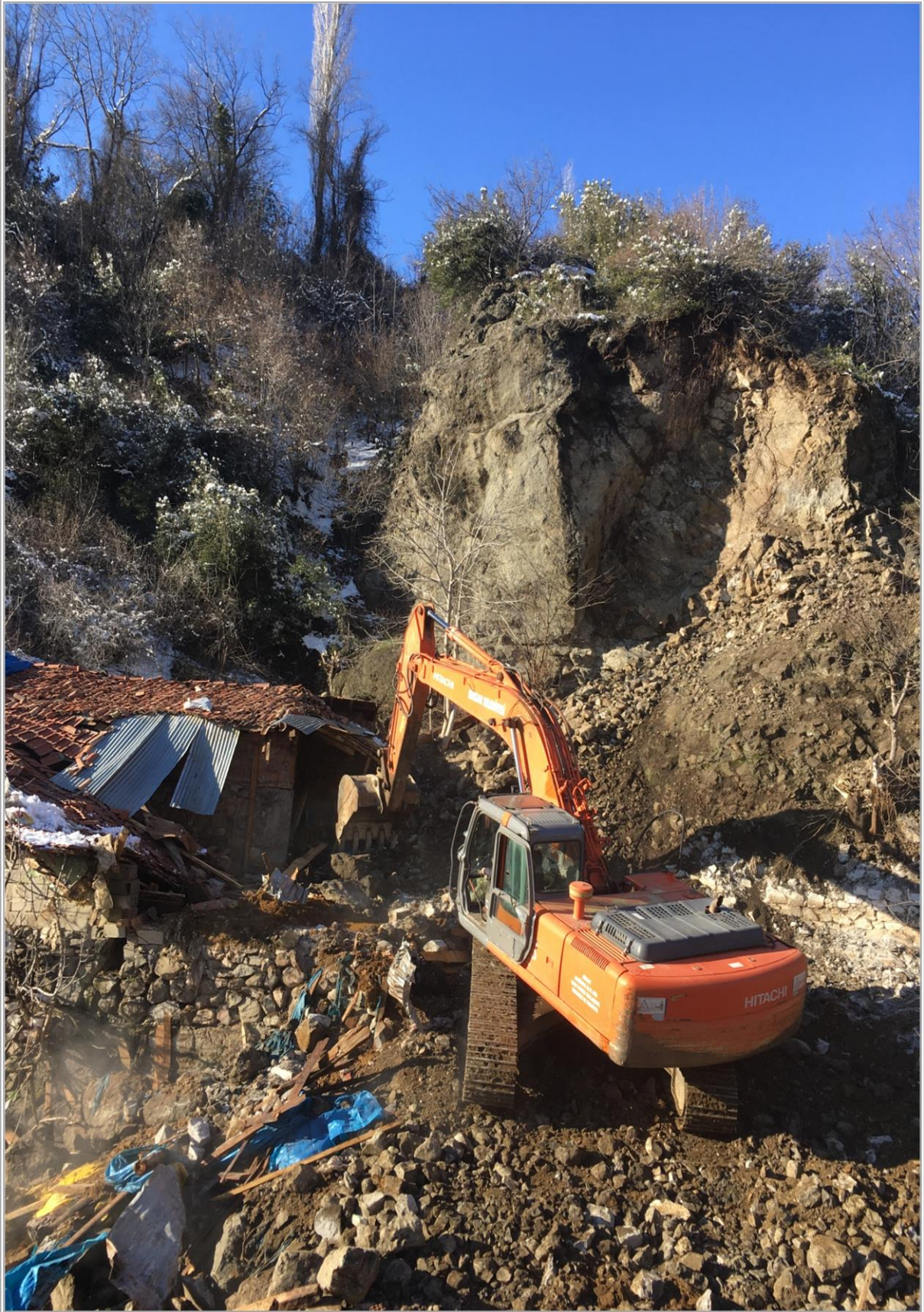
Resim 2.10: Tokat İli, Niksar İlçesi, Kayabaşı Mah. Kaya Düşmesi ve etkilenen Ahır*
