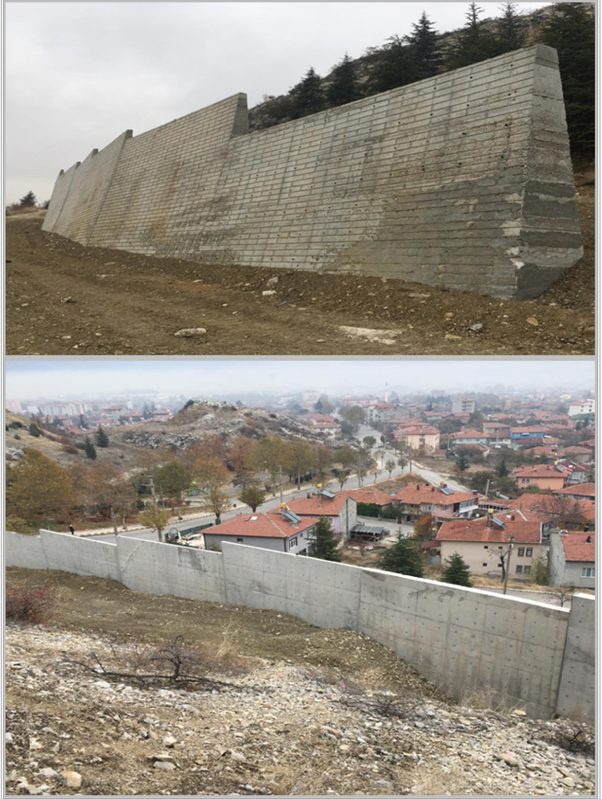
Resim 2.9: Tokat İli, Turhal İlçesi, Gürsel Mahallesi Kaya Düşmesi Islahı*
